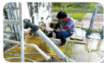
ท่อจ่ายน้ำ
