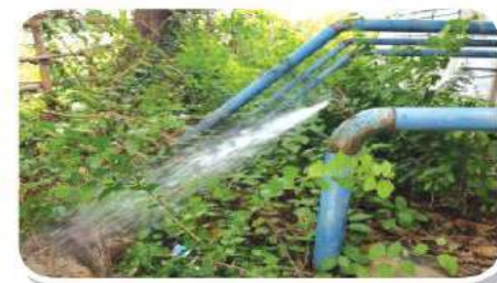
ท่อจ่ายน้ำ
