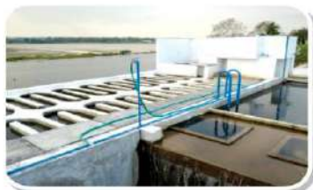
ถังสร้างตะกอน/ถังรวมตะกอน ถังตกตะกอน/ถังกรอง
