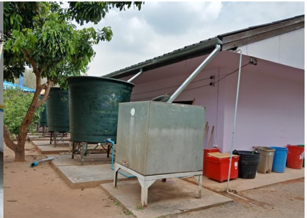
ถังเก็บน้ำฝน
