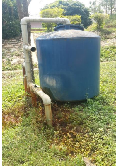
ถังกรองน้ำบาดาล ท่อเชื่อมชำรุด
