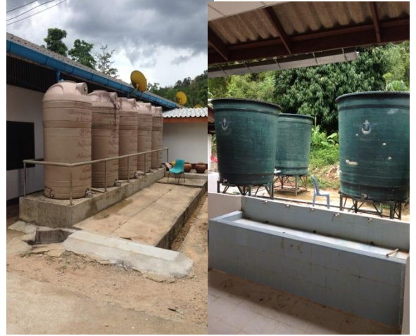
ถังเก็บน้ำฝน
