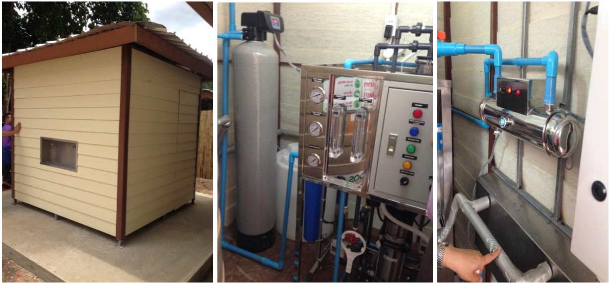
อาคารบริการน้ำดื่มและระบบปรับปรุงคุณภาพน้ำ
