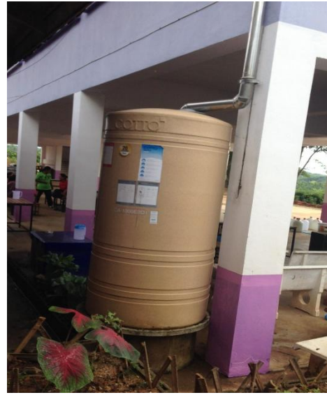
ถังเก็บน้ำฝน
