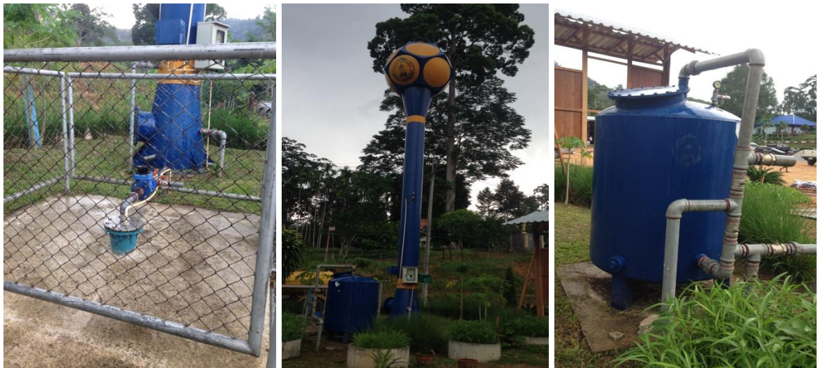
แหล่งน้ำบาดาลและระบบปรับปรุงขั้นต้น
