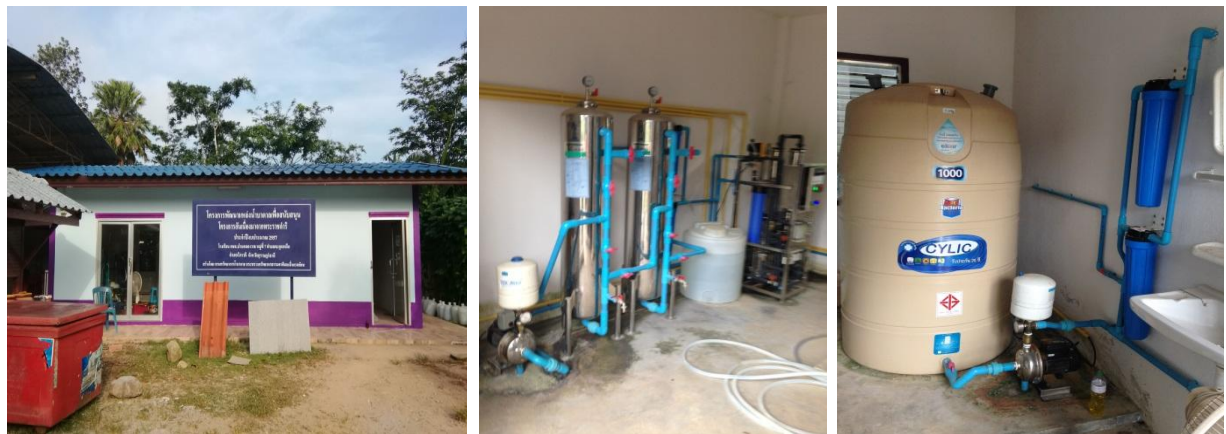
ระบบปรับปรุงคุณภาพน้ำดื่มของโรงเรียน (โรงผลิตน้ำดื่ม)
